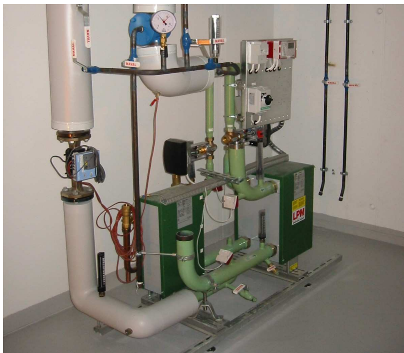
Figur 3-2, Eksempel på kundesentral med vekslere for oppvarming og varmt tappevann
